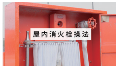
(2) 【屋内消火栓操作】 https://youtu.be/OJFR8L0Jtd4
