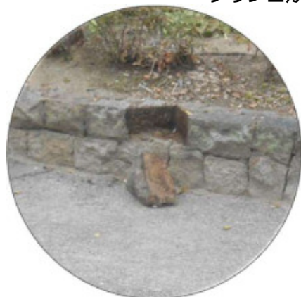
石積みが崩れている
