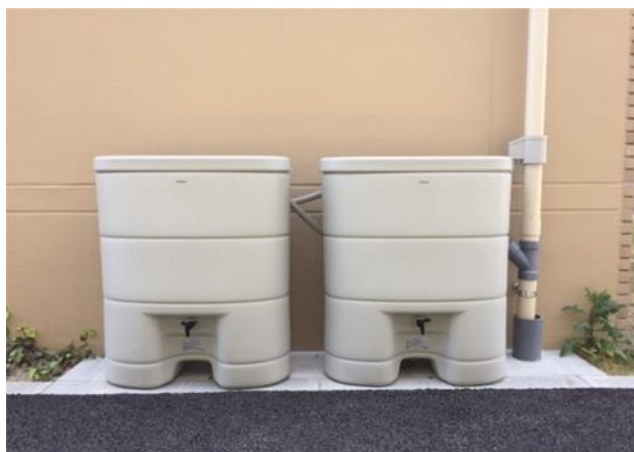
雨水貯留タンク(中央北生涯学習プラザ)
