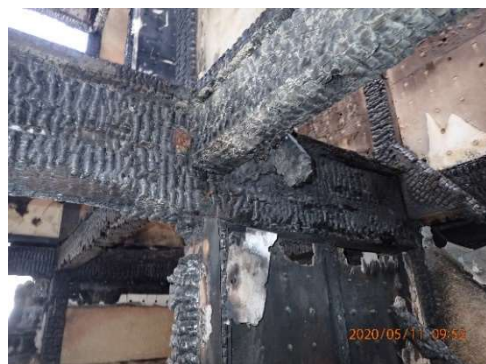
構造材の火災被害
