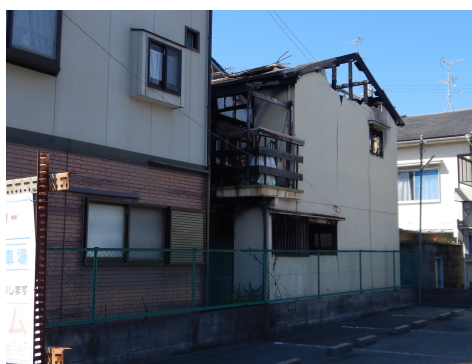
建物全体（屋根の崩落、外壁ひび割れ）
