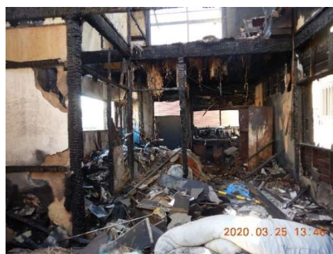
内部の被災状況
