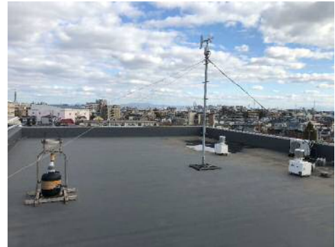
立花北小学校測定所（小学校屋上）
