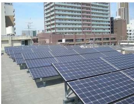
太陽光パネル
