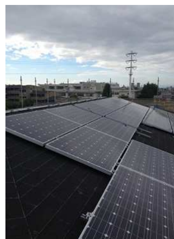
制度活用事例 不二電気工事（株） 自社事務所
