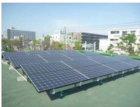
太陽光パネル
