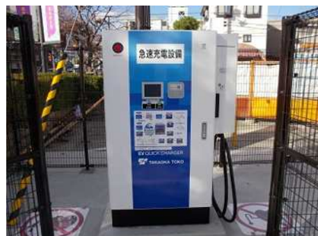
急速充電器（市役所本庁舎）
