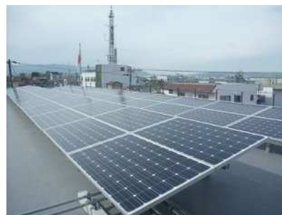
太陽光パネル
