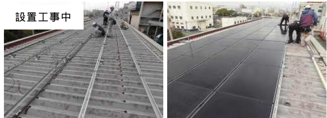
設置後（第1工場）
