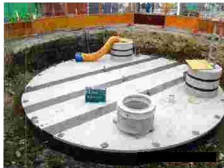
公園に備えた耐震性防火水槽
