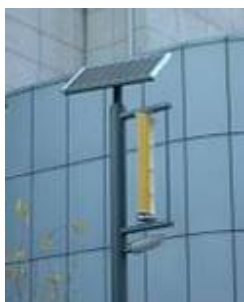
太陽光・風力発電付外灯
