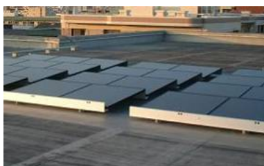
太陽光発電設備
