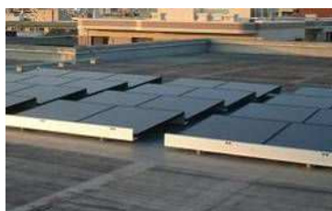
太陽光発電設備
