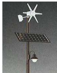
太陽光＋風力発電外灯の採用
