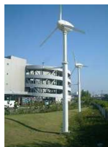
風力発電設備
