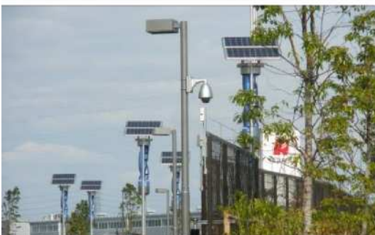
太陽光発電施設
