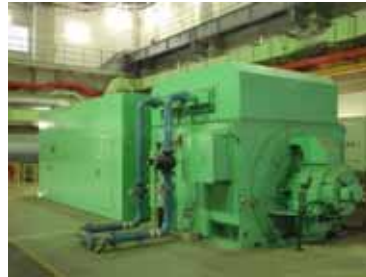
蒸気タービン発電機
