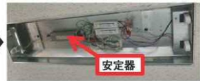
③ 安定器を確認してください。 安定器の表面に 銘板 が貼られています。
