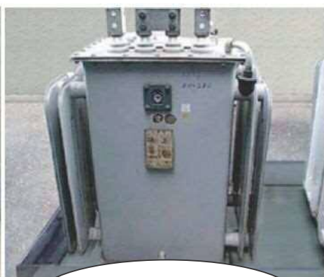
トランス(変圧器)
