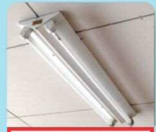
照明器具(蛍光灯)
