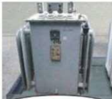
トランス(変圧器)
