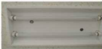
① 蛍光灯を外します。
