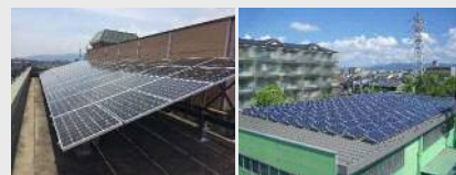
↑屋根貸し事業により設置された太陽光発電設備
