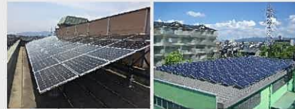
↑屋根貸し事業により設置された太陽光発電設備
