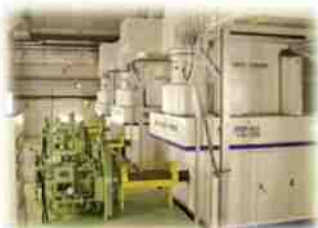
【地下1階：ポンプ施設】
