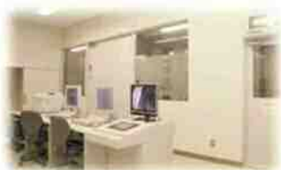
【3階：ポンプ操作室】
