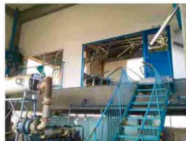
2階操作室内設備の破損・流出
