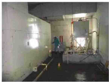
自家発電設備 浸水
