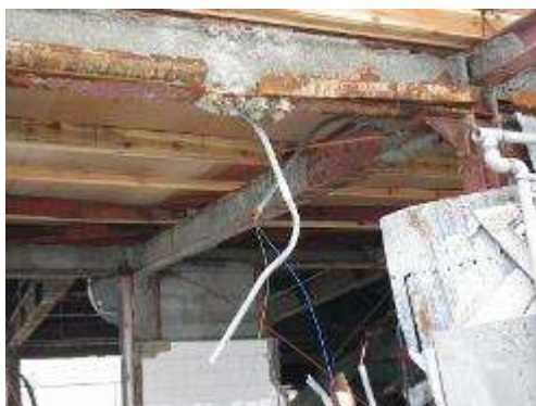
建物に残存した吹付け材
