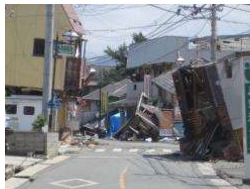
地震で損壊した建物
