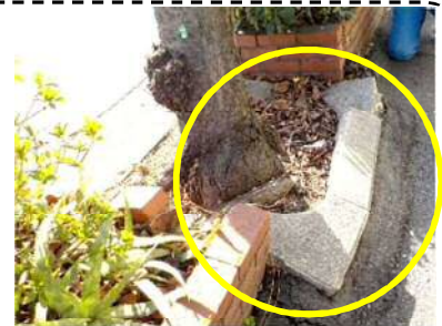
街路樹の根上がり
