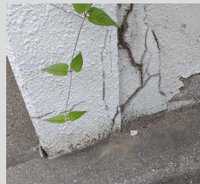
コンクリートの割れ目
