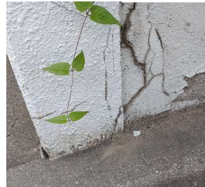
コンクリートの割れ目
