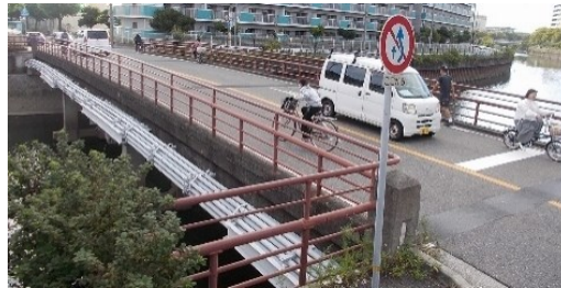
図 4.54 都市計画道路未整備箇所
