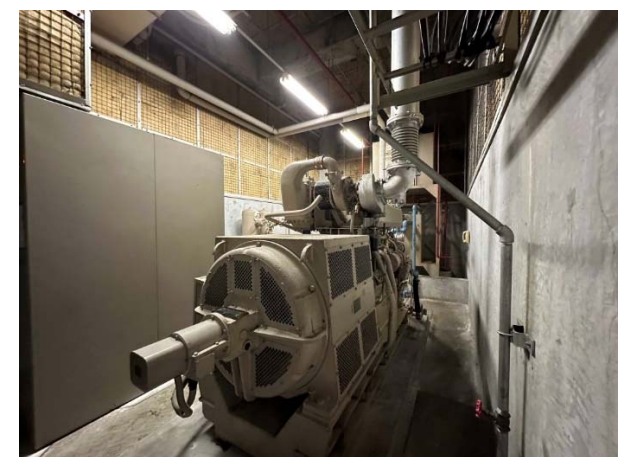
□写真 自家発電機室
