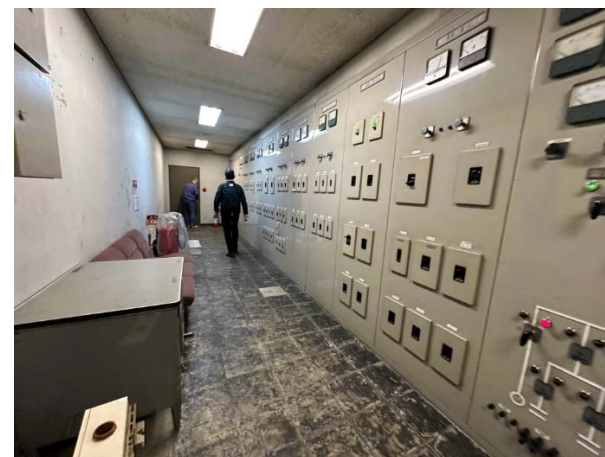
□写真 コントロール室
