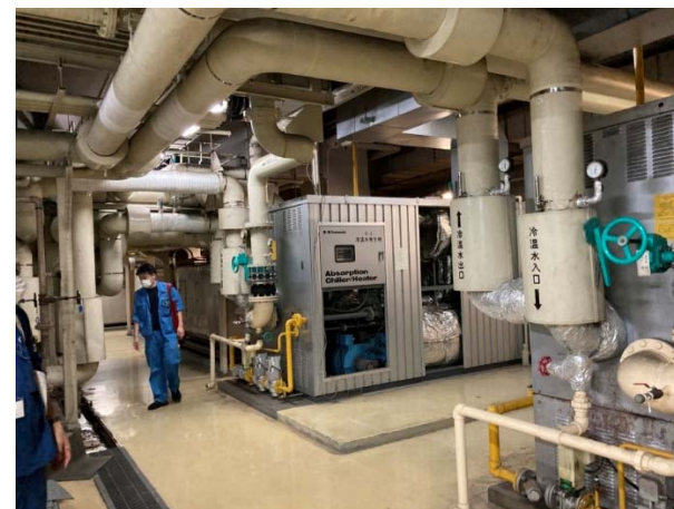
□写真 空調機械室
