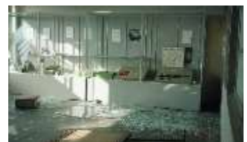
旧文化財収蔵庫 展示室の被害状況
